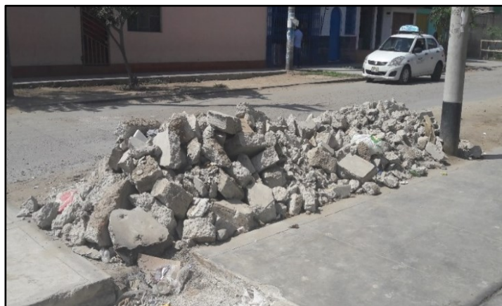
Figura 1: Residuos de Construcción en la vía pública
